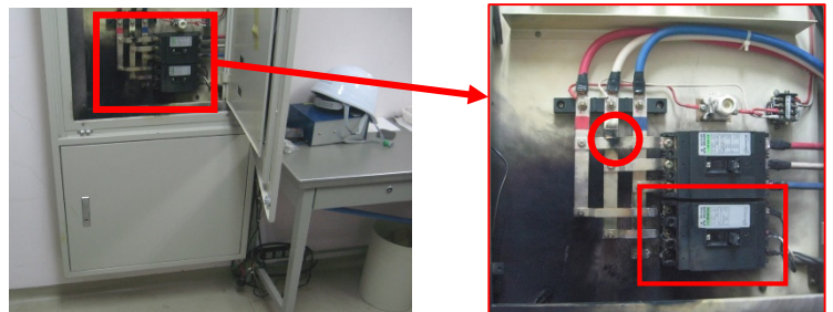
赤丸の部分が短絡箇所 赤□で囲った部分が溶融、発煙したブレーカー部分
